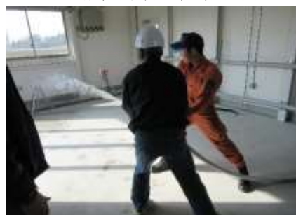
屋内消火栓での放水大権
